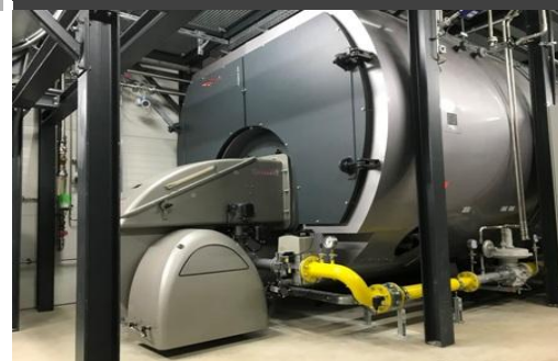
Der 15,5 t Dreizugkessel im inneren des Kesselhauses
